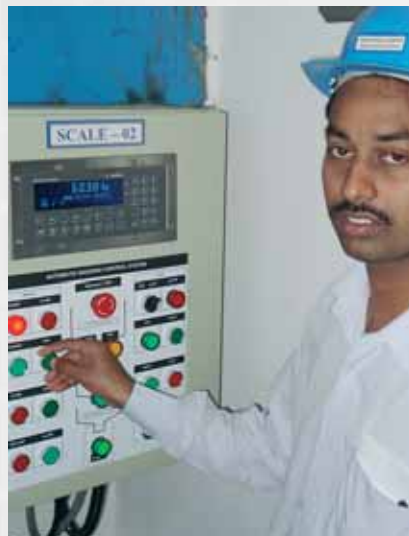
Vom Kontrollraum aus kann das Abfüllen in Säcke an der Bedienkonsole Schritt für Schritt ausgeführt werden.
