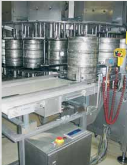
Sartorius Wägemodul WM120 ist direkt in die Produktionsanlage integriert.
